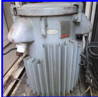
トランス（変圧器）
