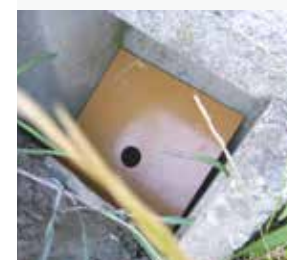
水田の排水口に設置した調整板。中 央の穴から少しずつ排水すること で、大雨時の急な河川の増水を防ぐ (写真提供=矢巾町産業観光課)
