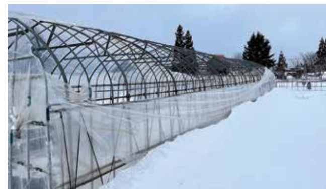
強風によるビニールの被害（令和3年2月16日撮影・八幡平市）
