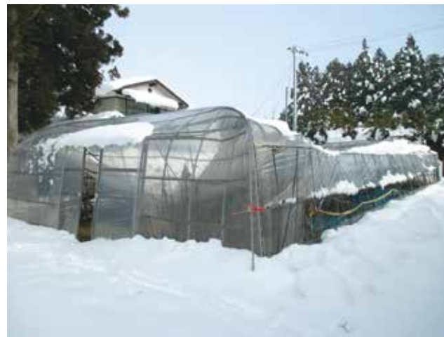
雪の重みで潰れた、設置して1年未満のハウス（令和2年12月、花巻市）
