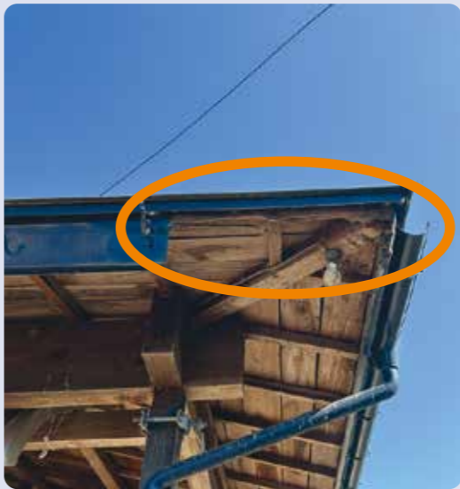
フロントローダーを装着したトラクターで農作業をしていたところ、誤って自宅に接触し、屋根が破損しました
