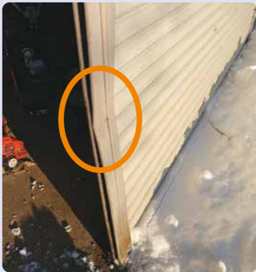
建物外部から誤って車両を衝突させ、中柱が曲がってシャッターが閉まらなくなりました
