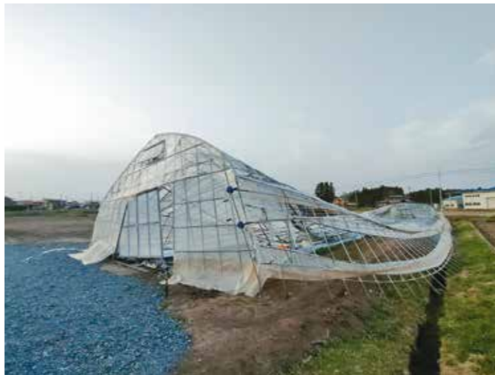
令和5年4月の強風により、パイプが抜けてビニールが剥がれたハウス (撮影場所：北上市)
